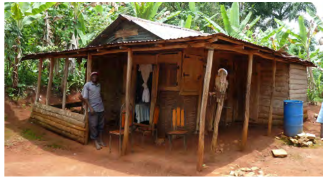
Maison à Carrefour : poteaux plantés dans le sol ; murs en clissage (non enduit) et bardage ( planch ) ; toiture à 2 pans en CGI ; galerie structurellement indépendante de la maison, «effet fusible» de la liaison entre les deux toitures.
