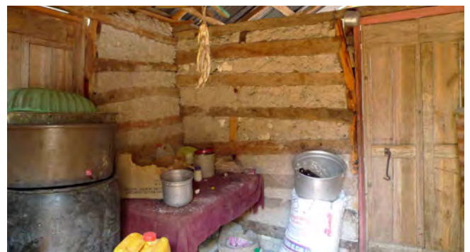
Planches de bois clouées aux poteaux, pour empêcher l'effondrement des panneaux de remplissage des murs vers l'intérieur de la maison, en cas de catastrophe.
