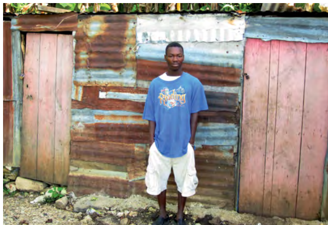
L'utilisation de tôles pour les murs et/ou toiture rend la température très élevée à l'intérieur de la maison.
