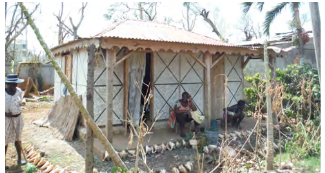
Photo prise juste après le cyclone « Matthew » (octobre 2016). Maison à Dame-Marie (Anse-d'Ainault, Grand'Anse), réalisée avec ossature bois et remplissage en maçonnerie de pierre (ti wòch) et clissage (klisay), en 2013 dans le cadre du « Programme Sandy », FICR.
